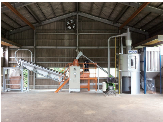
生産能力：150kg/h ペレット機：PT2242(22kw)
