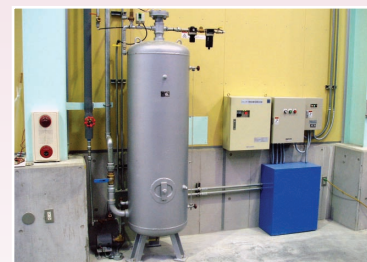
水消火加圧タンク 自動給水式
