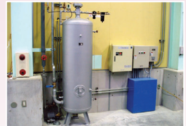
水消火加圧タンク 自動給水式
