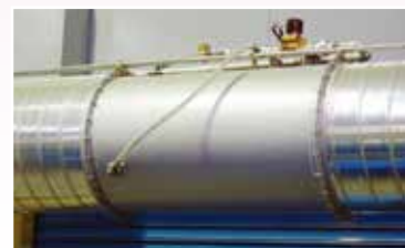
水消火ダクト
