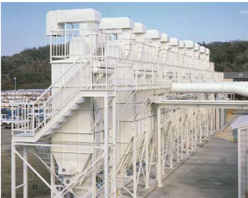
BFP20W24 : 7.5 kW BFP20W84 : 22 kW-2基 BFP20W112 : 30 kW-2基 セラミックス工場
