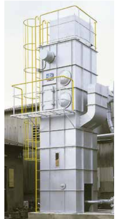
BFS36 : 5.5 kW 家具部材工場
