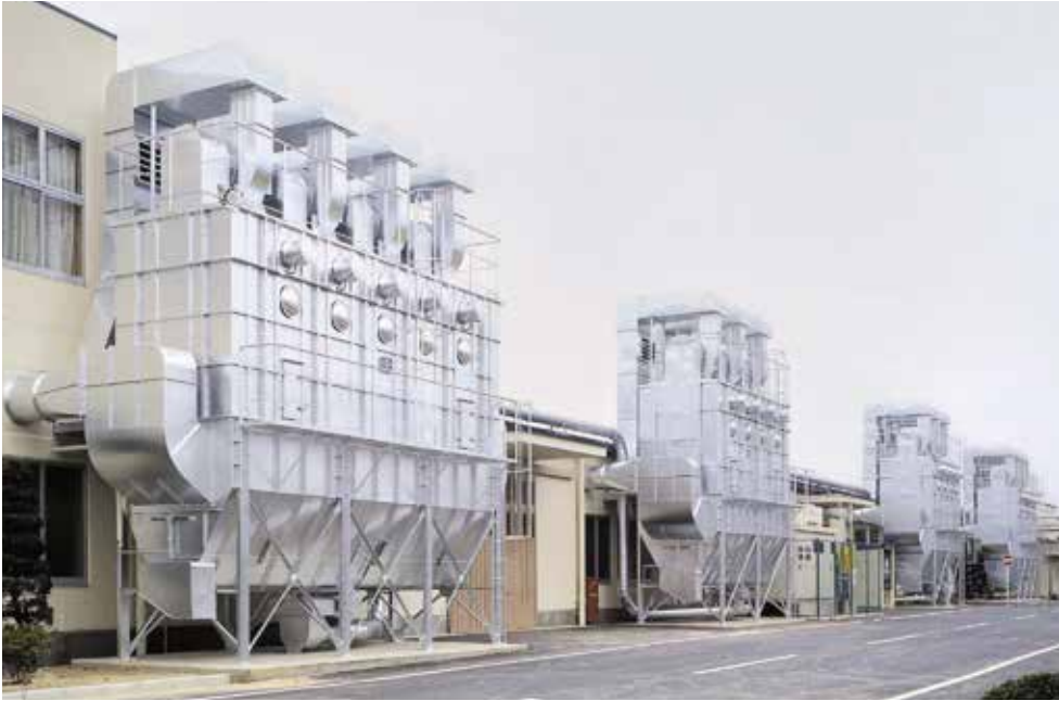
BFS216 : 45 kW-2基 BFS270 : 60 kW-2基 家具工場
