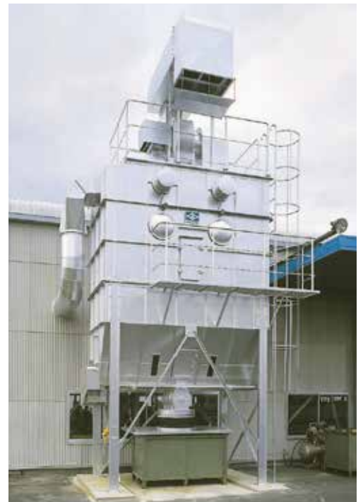
BFS96 : 15 kW 住宅部材工場
