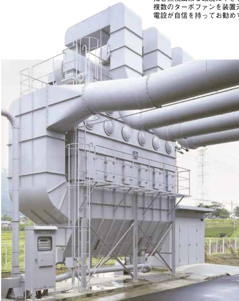
BFR4×6 : 45 kW 家具・住宅部材工場
