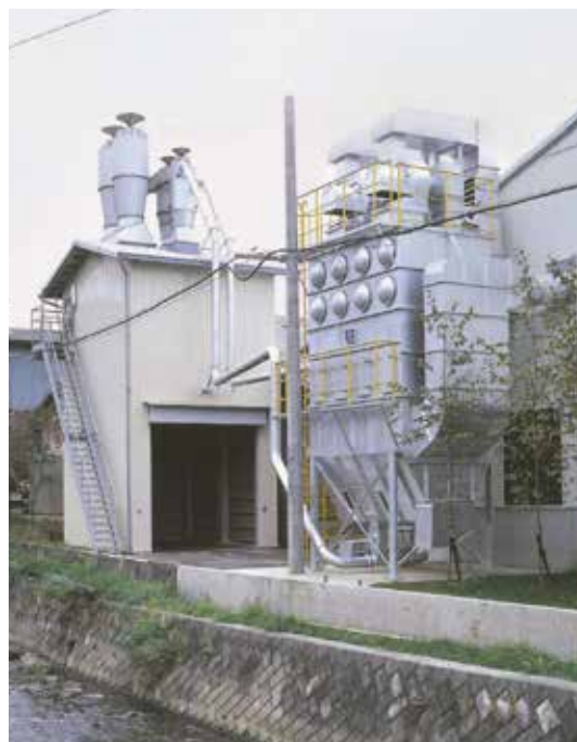
BFR3×4 : 22 kW 全自動プレカット工場
